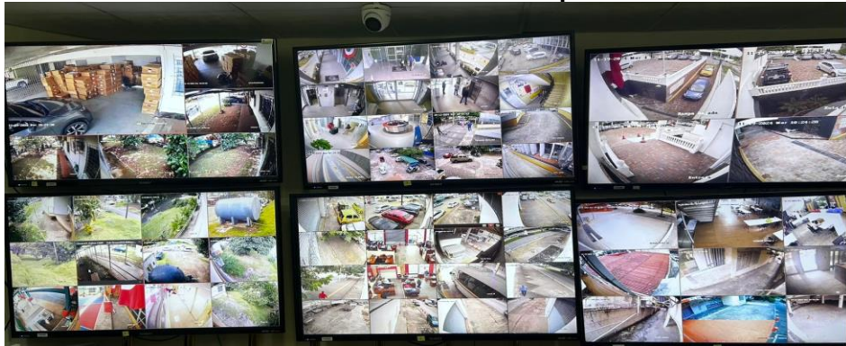
Ilustración No. 30 Centro de Monitoreo ubicado en la Planta Baja del Edificio de la Contraloría General de la República
