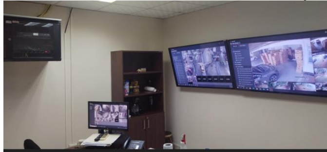
Ilustración No. 31 Cuarto de Monitoreo ubicado en la Planta Alta del Edificio Mercedes Pool de la Contraloría General de la República
